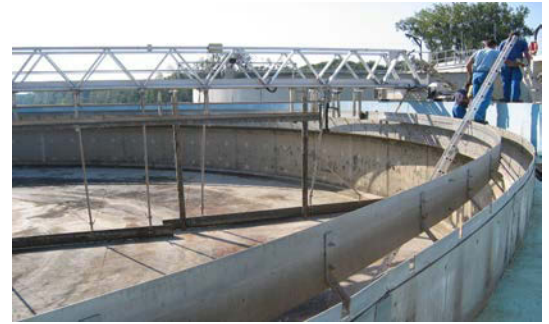
Clarificateur de station d'épuration
