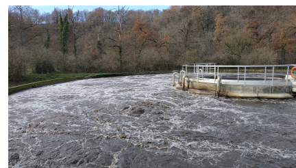
Bassin d'aération d'une STEU à boues activées
