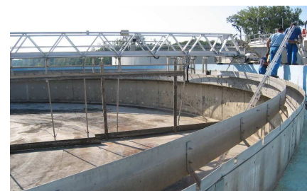
Clarificateur d'une STEU à boues activées
