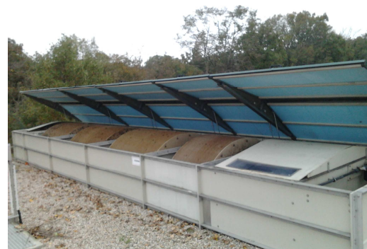
Station d'épuration à disques biologiques
